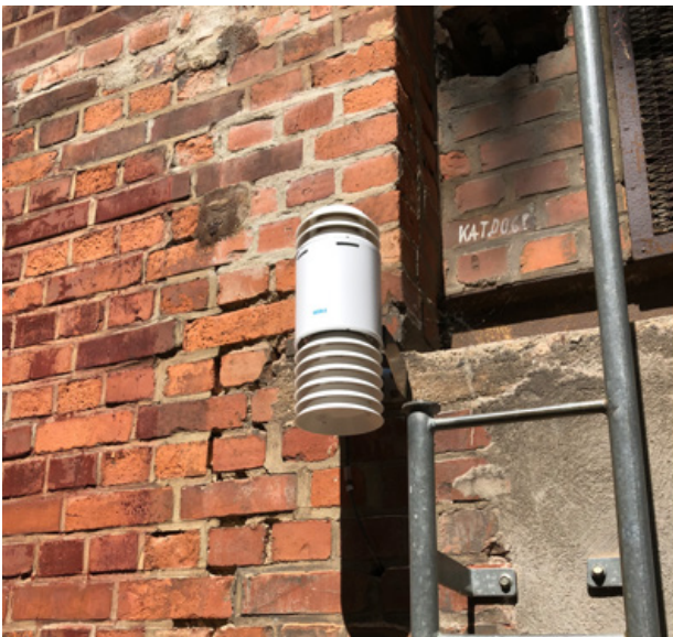
Luftqualitätssensoren auf der Baumwollspinnerei (Quelle: Cenero Energy GmbH)
