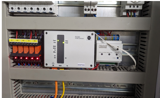
Verbauter Heizungsregler (Quelle: WSL Wohnen & Service Leipzig GmbH)
